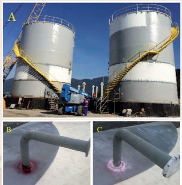
Figura 3 - Fiscalização in-loco de ensaio de líquido penetrante nas dependências do EBN, em Itaguaí-RJ.
